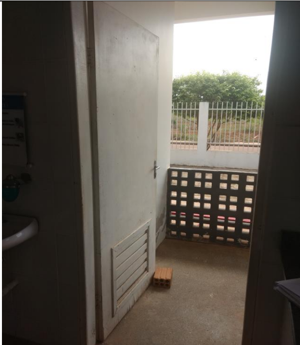
Foto 09 – Porta sem proteção
