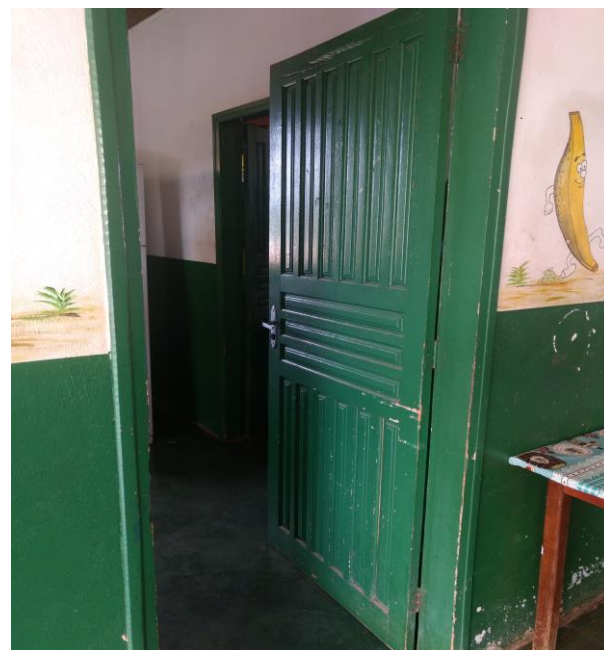
Foto 12 – Portas escuras/ sem proteção
