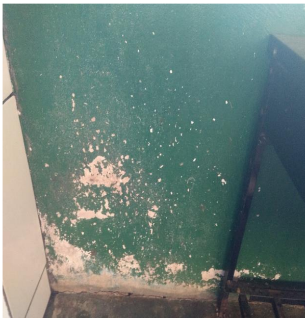
Foto 10 – Paredes com descolamento de rebovo
